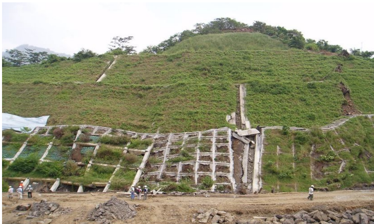
圖9 國道六號南投段路塹邊坡坍塌
