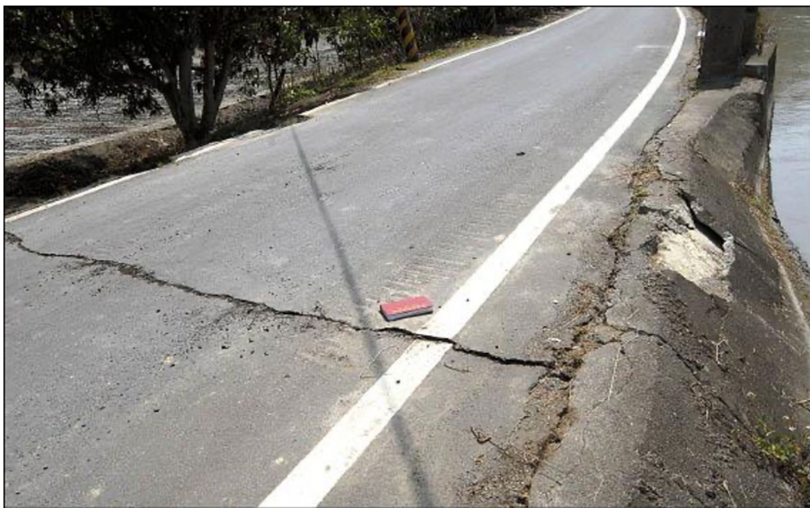
圖3 車籠埔斷層附近區域的地表裂隙
