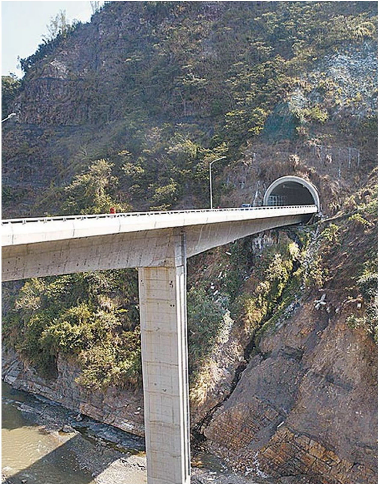
圖13 國道六號南投段隧道洞口邊坡破碎岩體
